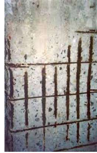
Şekil 13. Betonarme kolonda meydana gelmiş korozyon
